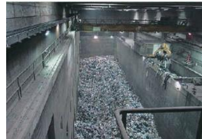
垃圾处理车间室内起重吊车移动供电
